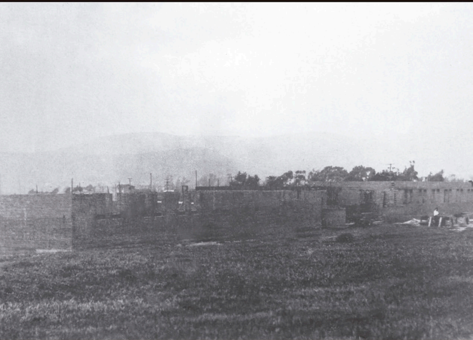
Construcción del cuartel de Infantería de Marina en Ensenada, Baja California, que posteriormente sería sede de la Compañía de Infantería de Marina Núm. 7
