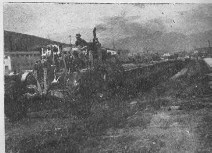
Construcción de la Avenida del Puerto de Ensenada, Estado de Baja California.
