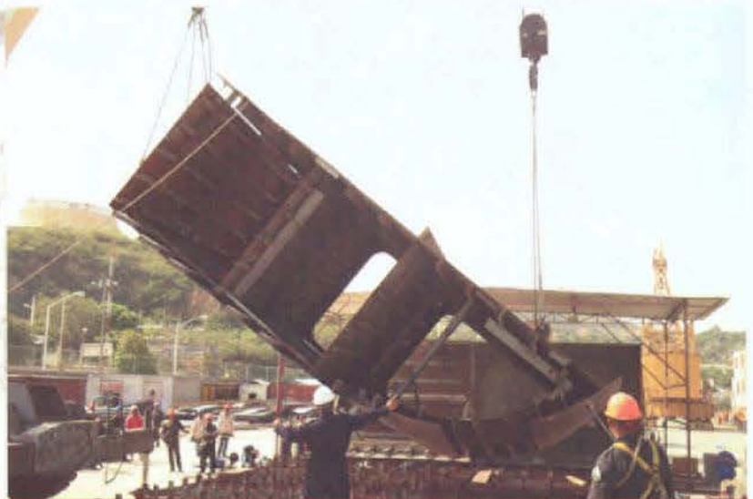
La coordinación de los equipos de trabajo es importante para el avance de la construcción
