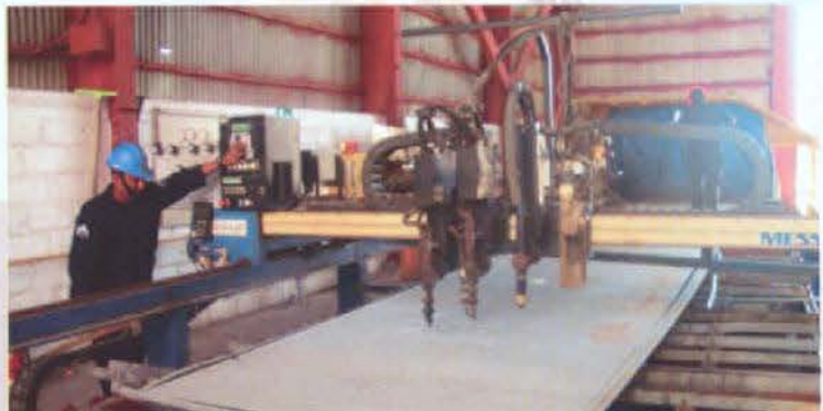
El sistema de corte de materiales por control numérico redujo en tiempo la primera etapa de construcción.
