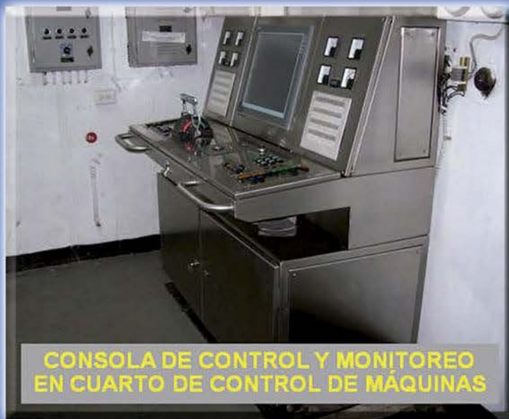
Esta consola, ubicada en el Cuarto de Control de Máquinas, controla y monitorea las señales de la planta propulsora.
