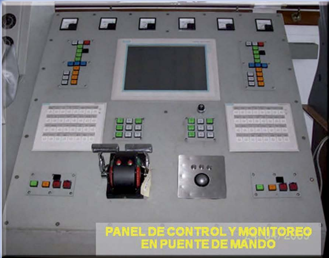
Panel de Control y Monitoreo instalado en el Puente de Mando para verificar los niveles de agua, aceite o combustible. Las pantallas táctiles o paneles electrónicos de botones permiten a los usuarios interactuar con el sistema.
