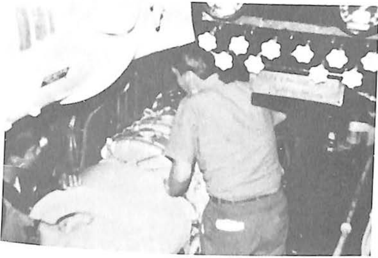
Ajustes finales para la prueba inicial de la unidad suministradora de energía eléctrica.
