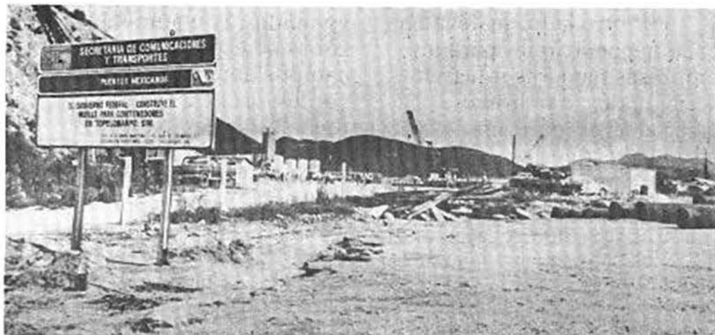
La Secretaría de Comunicaciones y Transportes, en coordinación con el gobierno del Estado, construye el nuevo muelle de contenedores.
