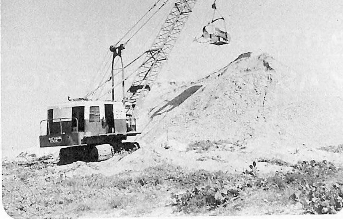
Grúa número 2 de la línea "EGO" excavando para el canal donde se introduciría la draga "Progreso", en Yucalpetén.
