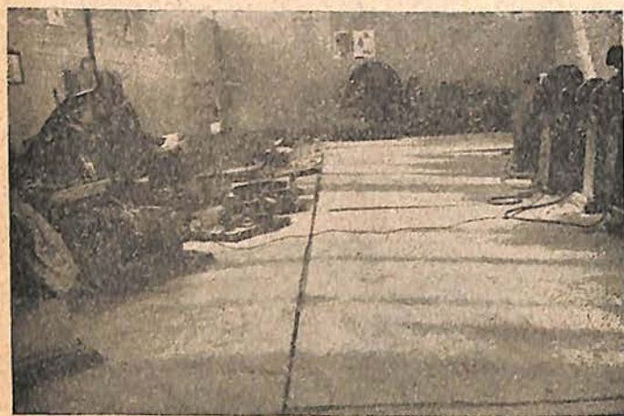
Taller Mecánico del Astillero de Marina que muestra los daños causados en piso y paredes.
