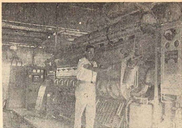
Motor Diesel General Motors de 1.000 K.W., instalado en Tapachula, Chiapas, para la Comisión Federal de Electricidad.
