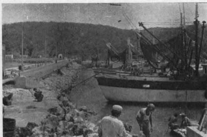
El muro terminará en donde está la baliza. El tramo comprendido entre ella y la caseta de madera (150 M. L.) sería el lugar indicado para construir el atracadero para pesqueros. Campeche, Cam.
