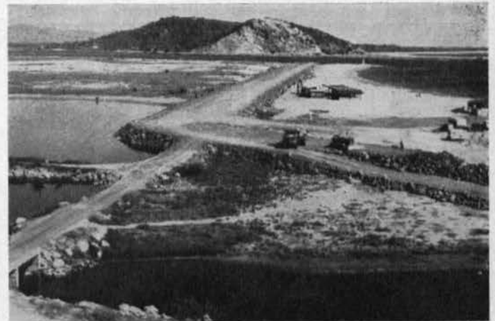
Vista general del acondicionamiento de la escollera paralela a la playa Sur.—Mazatlán, Sin.
