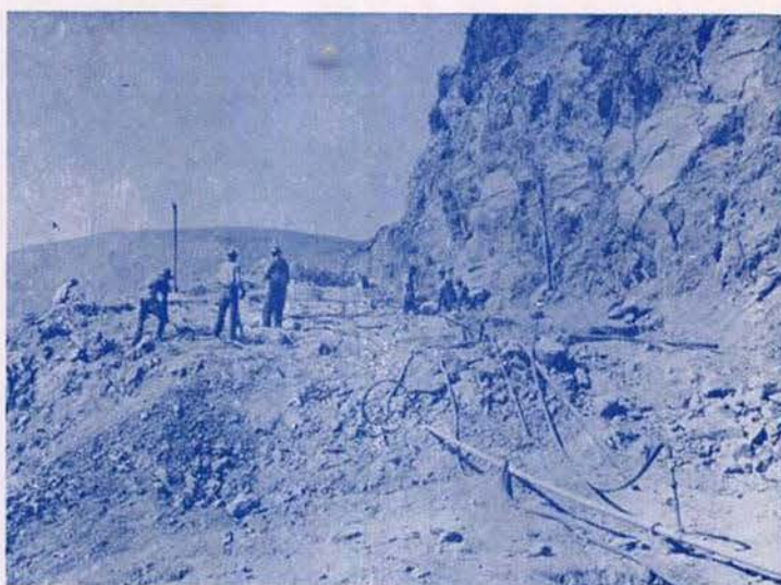
Trabajadores de Chapultepec, S. A. (antes Clark y Mansilla) en pleno trabajo de barrenación en las obras portuarias en Ensenada, B. C.
