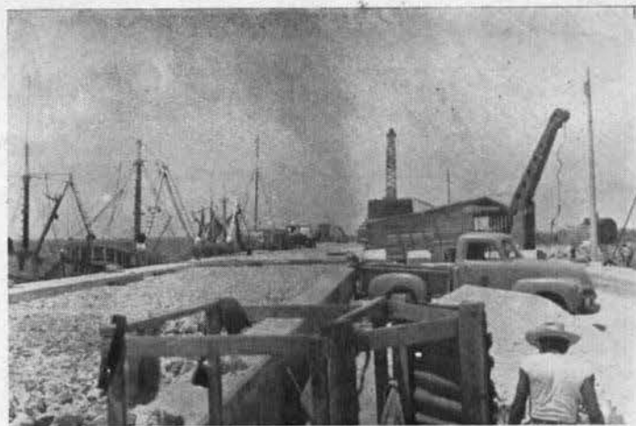
Muro de contención que fue necesario construir para lograr que toda la superficie de los atracaderos quede a la misma cota. Este muro se hizo debido a que el pedrapién del muelle no tiene la misma altura en toda su longitud.—Campeche, Cam.
