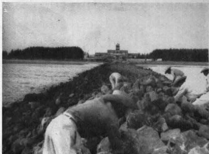
Acomodando material para el perfilado de la corona y talud del espigón de acero al muelle, con una longitud de 380 mts y un ancho de 6.00 mts, en la corona.—Antón Lizardo, Ver.
