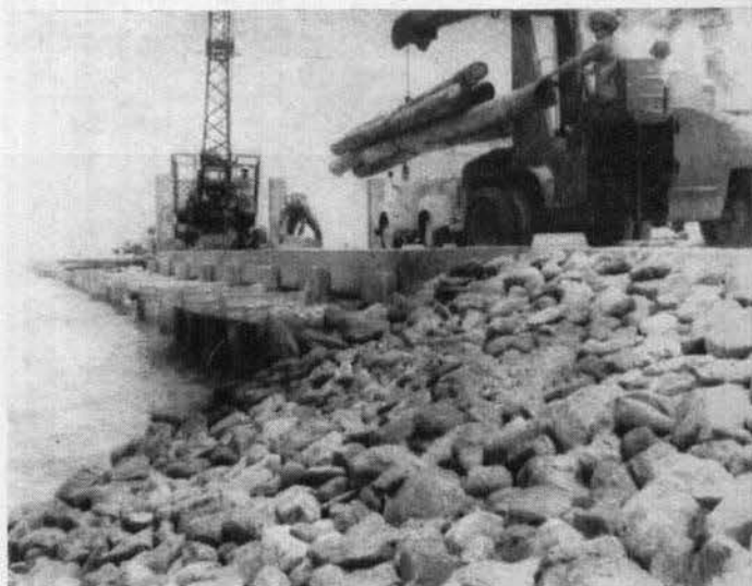
Remolcando los 3 últimos pilotes suplementarios. 1er. tramo de muelle terminado mostrando las mángulas de los cabezales y las losas precoladas del piso del muelle.—Antón Lizardo, Ver.
