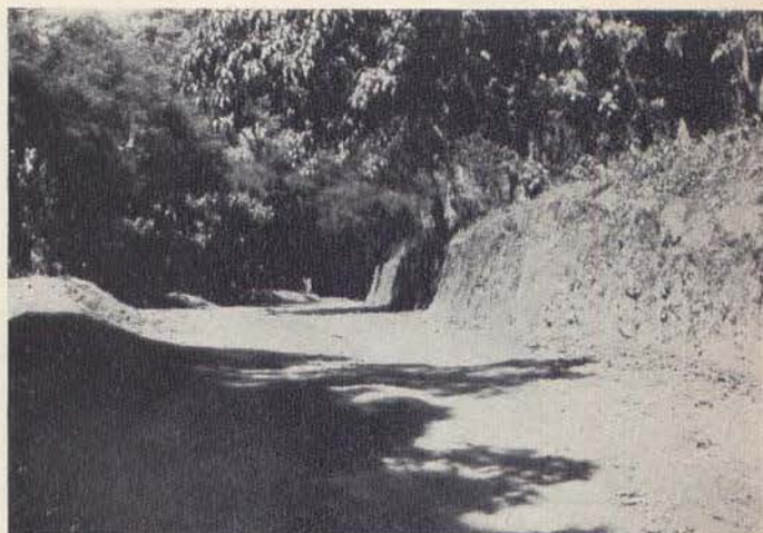
Arreglo del camino para construcción agregados. Construye Cía. General de Construcciones, S. A. Vista parcial en el kilómetro 0 más 800. Puerto Angel, Oax.
