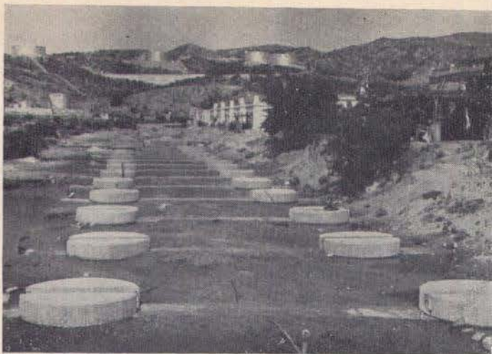
Pilas de concreto, del Muelle de reparaciones a flote, que se construye en la Dársena del Puerto de Salina Cruz, Oax.
