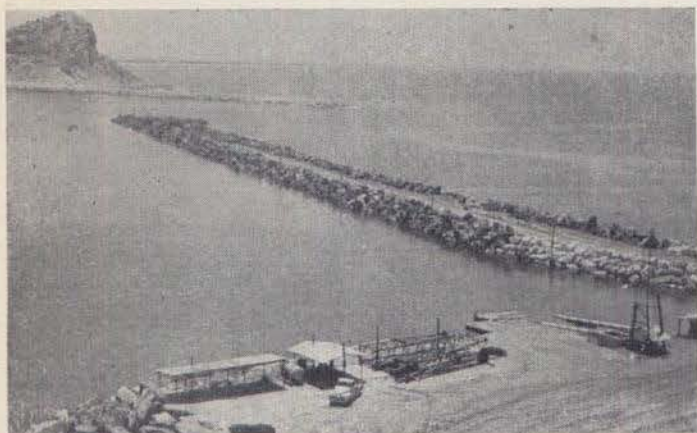
Talud lado puerto del Rompeolas Crestón en toda su longitud. (En construcción). Al frente el Rompeolas de Chivos
