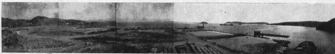
Atracadero con paredes formadas por un sistema Celular de Tablaestacas metálicas, y obras conexas de relleno y recubrimiento, en el Puerto de Guaymas, Son. Obras a cargo de la Compañía "U T A H", S. A.
