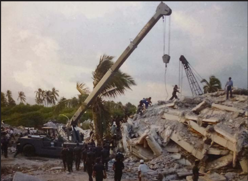
En 1995, un sismo de gran magnitud afectó el puerto de Manzanillo, Colima.
