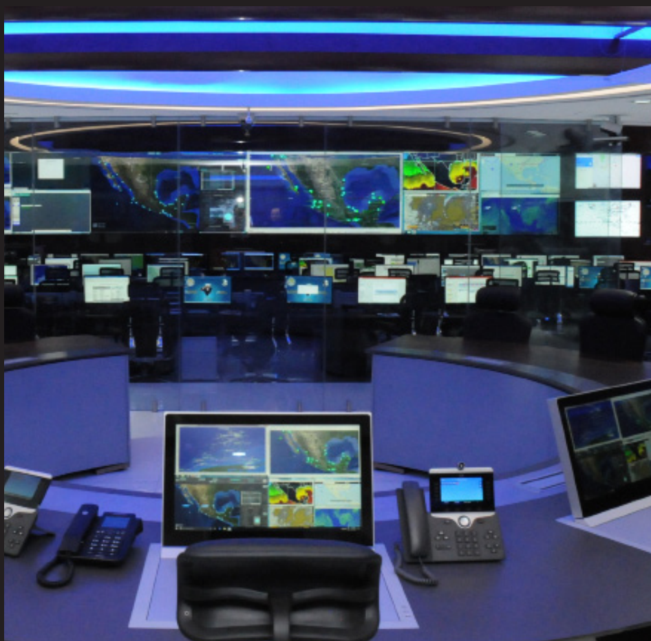
Instalaciones del Centro de Mando y Control.
