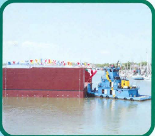
Únicamente se han botado dos secciones del dique que contará con un total de seis.
