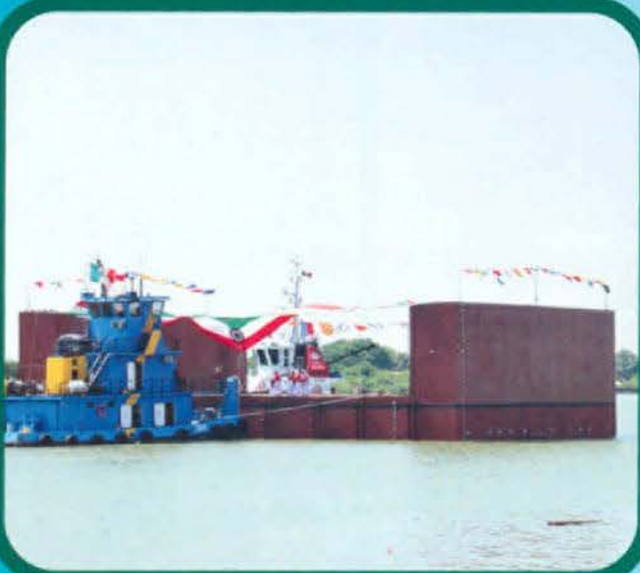
Los remolcadores empujan la estructura para colocarla junto al muelle donde continuará la siguiente fase de construcción.
