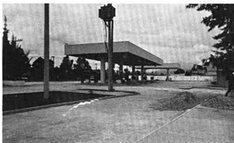
Gasolinera, estación que se construye en la esquina de las avenidas Cafetales y La Virgen, en la ciudad de México.
