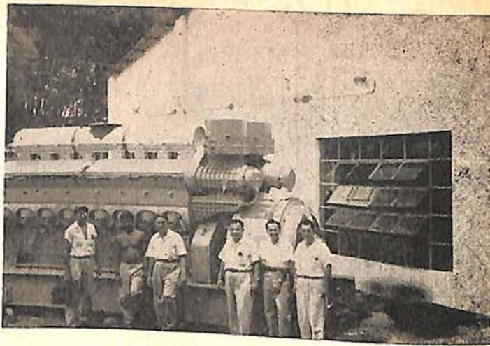
Motor Diesel GM., de 1500 H. P., en proceso de montaje en Tapachula, Chiapas.
